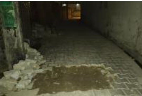
ਪਾਣੀ ਦਾ ਕਨੈਕਸ਼ਨ ਲੈਣ ਲਈ ਪੁੱਟੀ ਗਈ ਗਲੀ ਦੋਪਹੀਆ ਵਾਹਨ ਚਾਲਕਾਂ ਅਤੇ ਪੈਦਲ ਆਉਣ-ਜਾਣ ਵਾਲਿਆਂ ਨੂੰ ਕਾਫੀ ਪਰੇਸ਼ਾਨੀ ਦਾ ਸਾਹਮਣਾ ਕਰਨਾ ਪੈ ਰਿਹਾ ਹੈ। ਕਈ ਲੋਕ ਤਾਂ ਅਚਾਨਕ ਇਸ ਜਗ੍ਹਾ 'ਤੇ ਪਹੁੰਚ ਕੇ ਠੋਕਰ ਲਵਾ ਲੈਂਦੇ ਹਨ ਜਦਕਿ ਦੋਪਹੀਆ ਵਾਹਨ ਚਾਲਕਾਂ ਨੂੰ ਲੰਘਣ ਸਮੇਂ ਇੱਕਦਮ ਝਟਕਾ ਲੱਗਦਾ ਹੈ ਜਿਸ ਨਾਲ ਉਹਨਾਂ ਨੂੰ ਸੱਟ ਆਦਿ ਲੱਗਣ ਦਾ ਡਰ ਰਹਿੰਦਾ ਹੈ। ਪਾਣੀ ਦਾ ਕਨੈਕਸ਼ਨ ਲੈਣ ਲਈ ਪੁੱਟੀ ਗਈ ਇਸ ਗਲੀ ਬਾਰੇ ਜਲ ਘਰ ਦੇ ਕਰਮਚਾਰੀ ਨੂੰ ਵੀ ਦੱਸਿਆ ਗਿਆ ਸੀ ਜਿਸ ਨੇ ਕਿਹਾ ਕਿ ਉਹ ਸੰਬੰਧਿਤ ਮਕਾਨ ਮਾਲਕ ਨੂੰ ਗਲੀ ਠੀਕ ਕਰਵਾਉਣ ਲਈ ਕਹਿ ਦੇਵੇਗਾ। ਵਾਰਡ ਨਿਵਾਸੀਆਂ ਨੇ ਮੰਗ ਕੀਤੀ ਹੈ ਕਿ ਪੁੱਟੀ ਗਈ ਨੂੰ ਜਲਦੀ ਠੀਕ ਕੀਤਾ ਜਾਵੇ ਤਾਂ ਜੋ ਕੋਈ ਐਵੇਂ ਹੀ ਸੱਟਾਂ ਨਾ ਲਵਾ ਬੈਠੇ।
